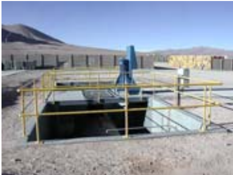
Foto 4. Estanque para el almacenamiento de aceite usado de contratistas en Minera Escondida Limitada.
