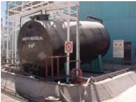
Foto 5. Estanque de almacenamiento de aceite usado en Minera Escondida destinado a combustible alternativo para una Planta de Cemento.
