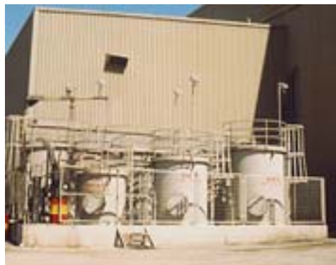
Foto 2. Estanque de almacenamiento de aceite usado en minera Candelaria.
